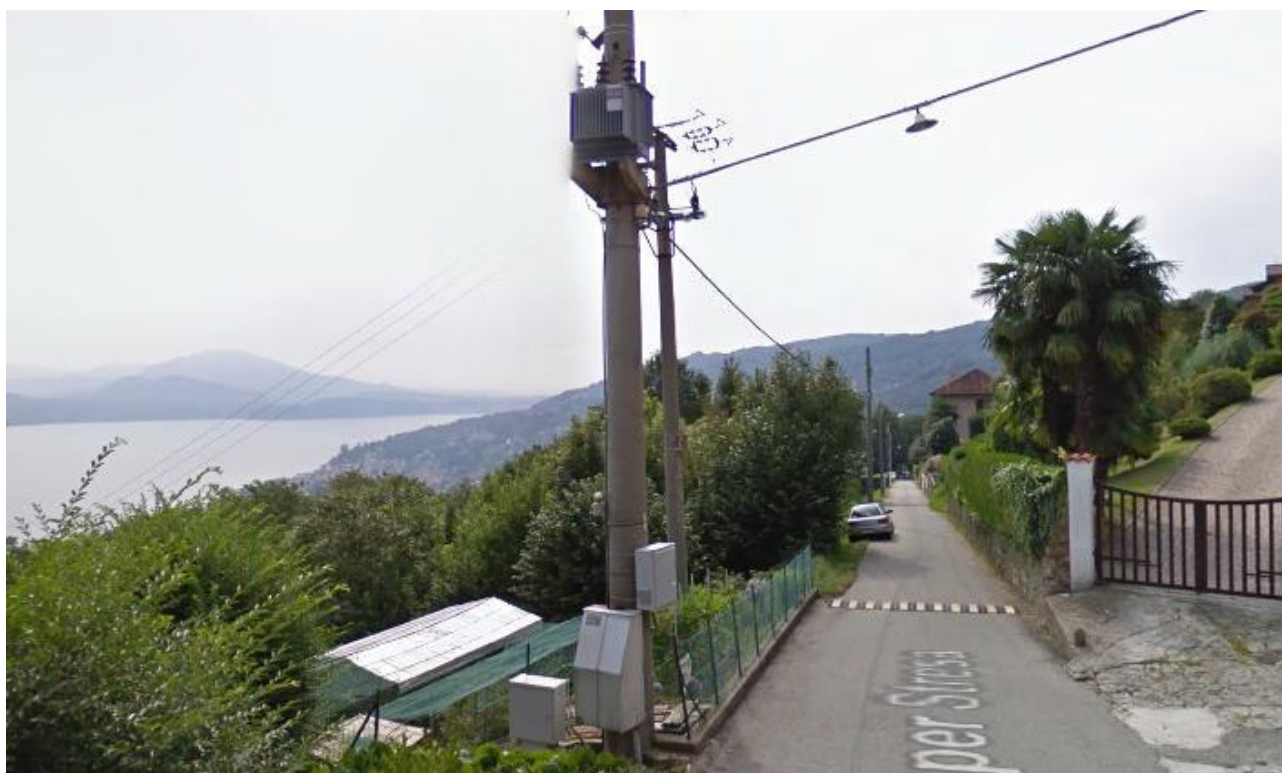
QE0029 Someraro - ubicato su cabina palo ENEL all'inizio della strada vecchia per Stresa
