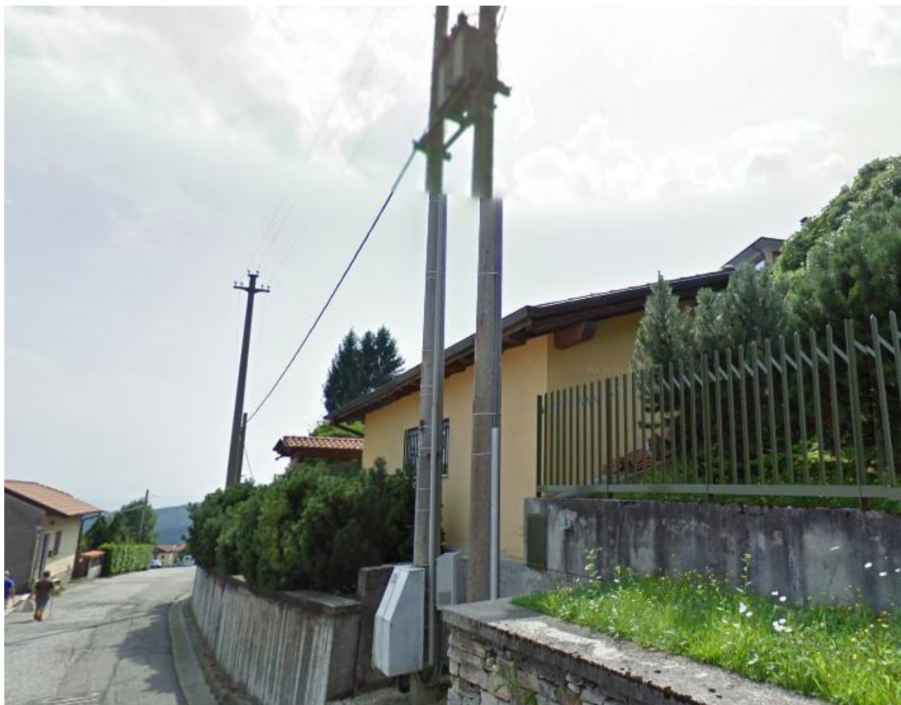
QE0027 Levo - ubicato su cabina palo ENEL al termine di via Mottarone
