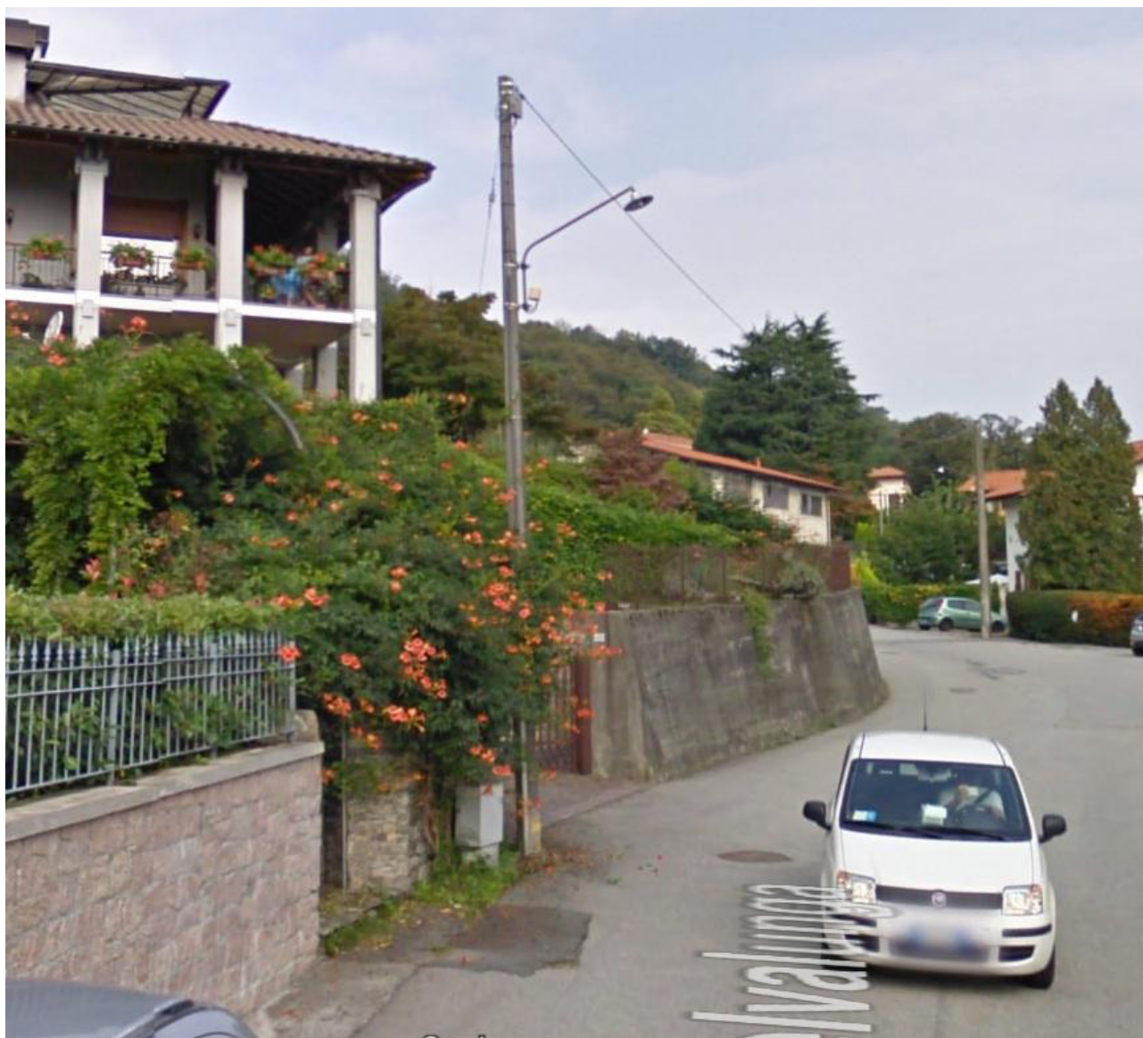
PALO IN CEMENTO CON SBRACCIO IN ACCIAIO VIA SELVALUNGA - TIPICO CON PROMISCUITA' MECCANICA
