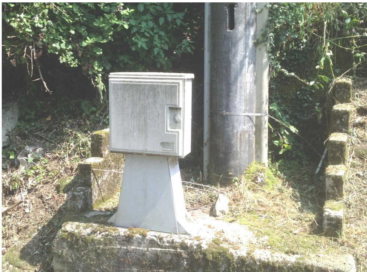
QE0018 Vendasco - ubicato in cabina palo ENEL sulla via per Brisino
