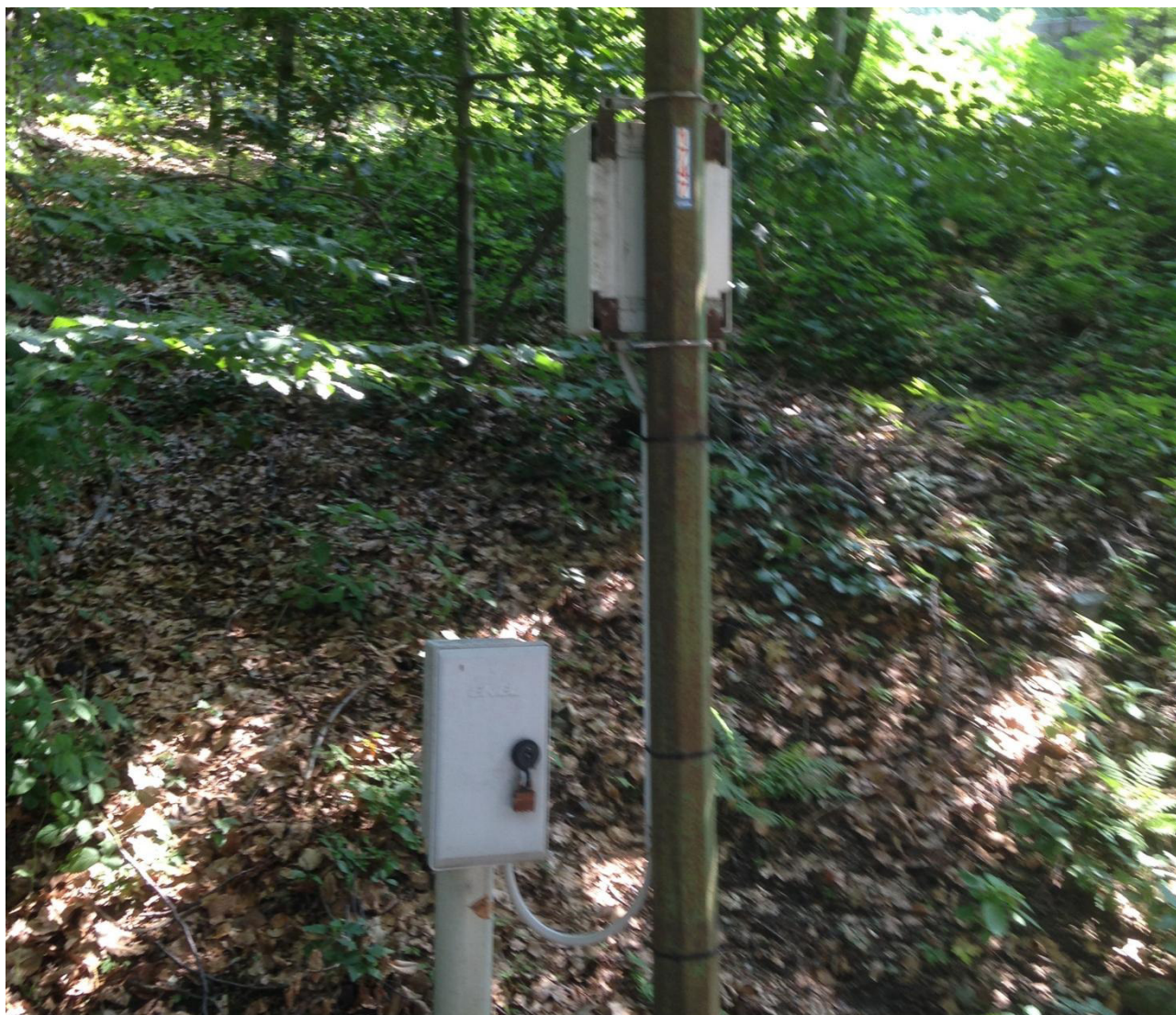
QE0061 Brisino - ubicato entro conchiglia base palo in via per Locco
