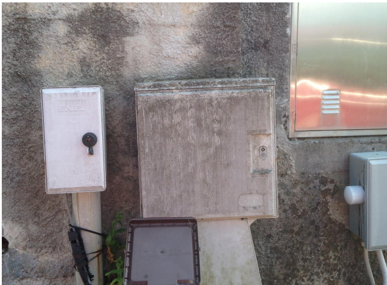
QE0063 Brisino - ubicato entro conchiglia a muro in strada vecchia per Brisino
