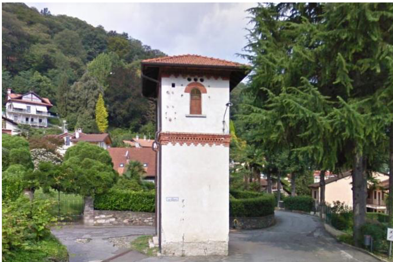
QE0037 Carciano - ubicato entro cabina ENEL nello slargo di via S. Martino e Solferino
