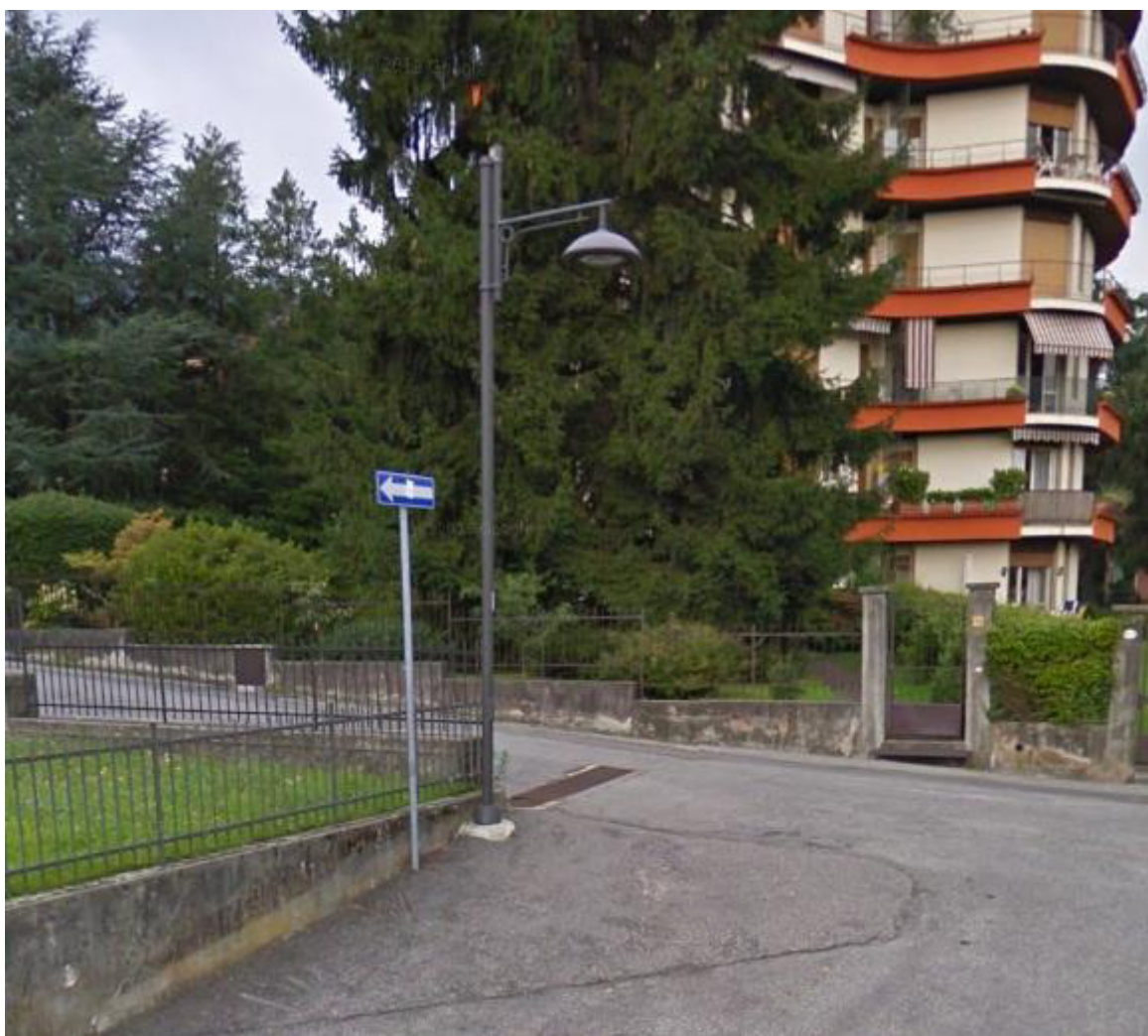
PALO ORNAMENTALE IN ACCIAIO A 1 BRACCIO VIA VIRGILIO
