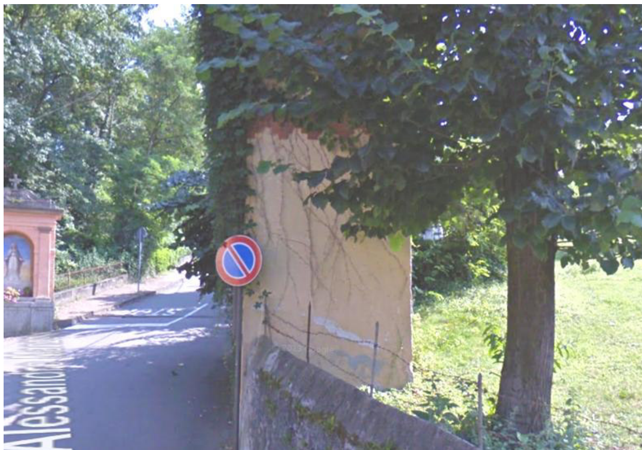
QE0013 Stresa sud - ubicato entro cabina ENEL di via Manzoni
