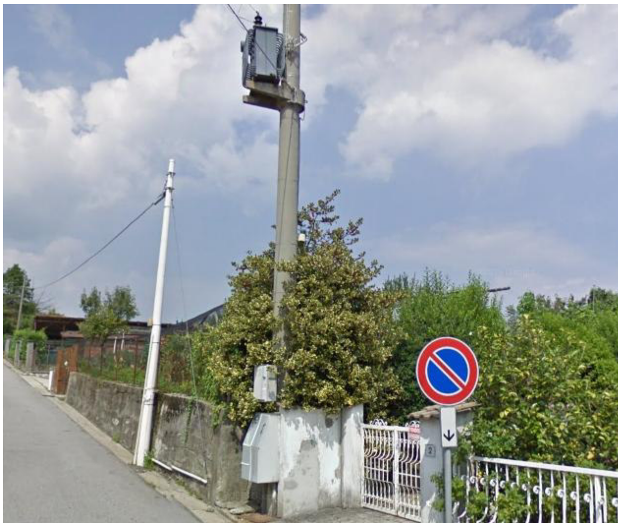
QE0026 Levo - ubicato su cabina palo ENEL all'inizio di via Mottarone
