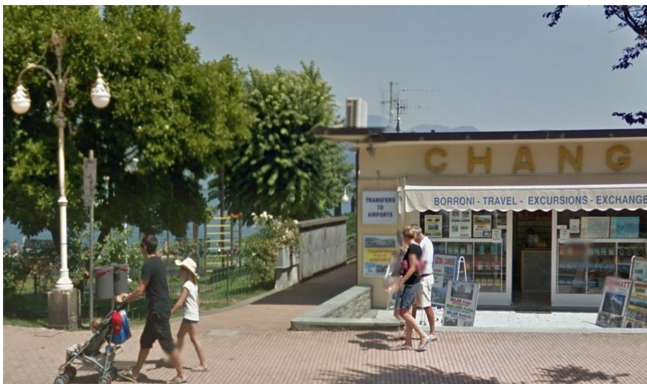
QE0053 Stresa lungo lago - ubicato entro armadio metallico a fianco del chiosco
