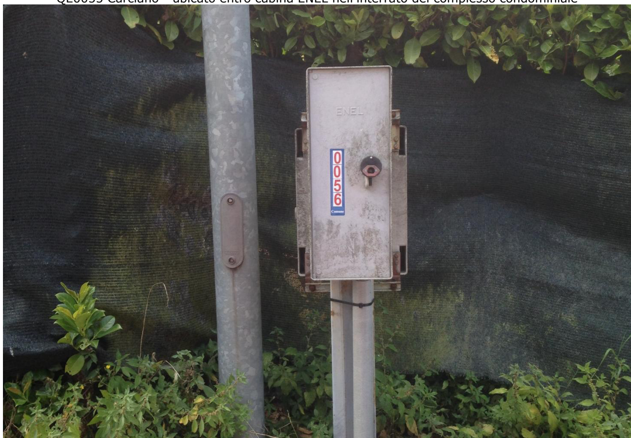
QE0056 Stresa nord - ubicato entro conchiglia alla base di palo PI su via Trentinaglia
