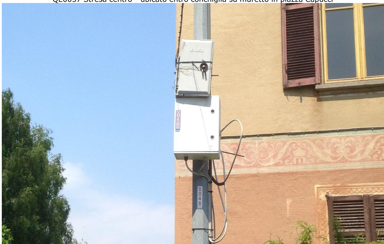
QE0058 Stresa centro - ubicato entro conchiglia su palo PI in via Crocifisso
