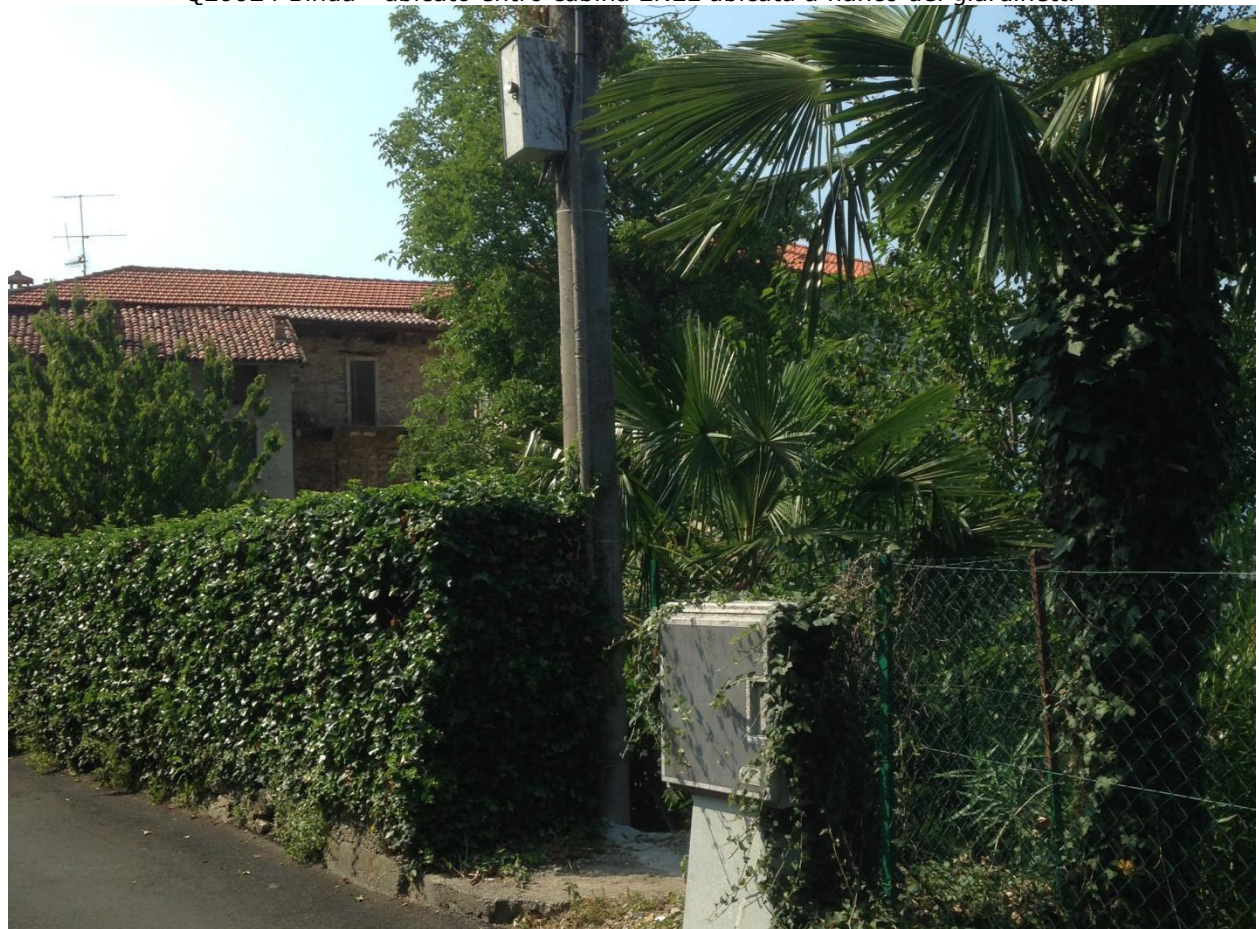
QE0025 Passera - ubicato su palo ENEL in via di Mezzo
