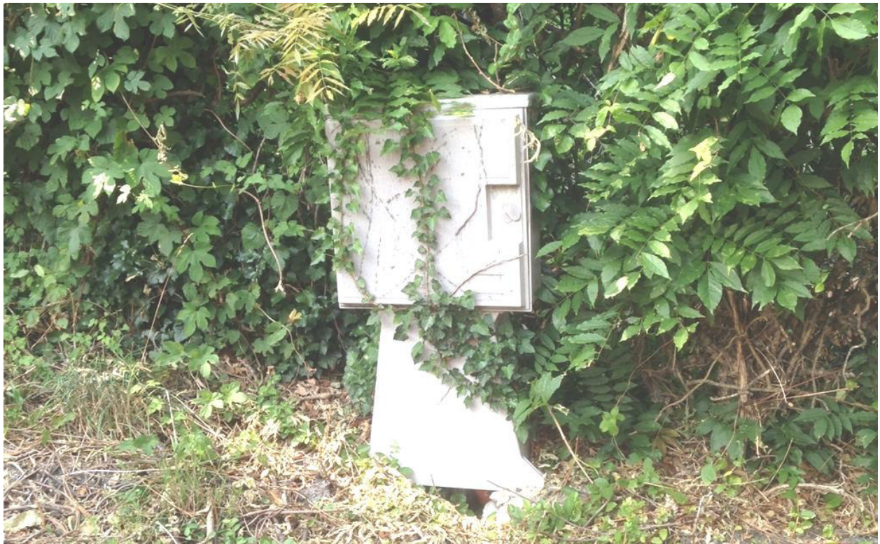
QE0022 Binda - ubicato si cabina palo ENEL in via per Binda
