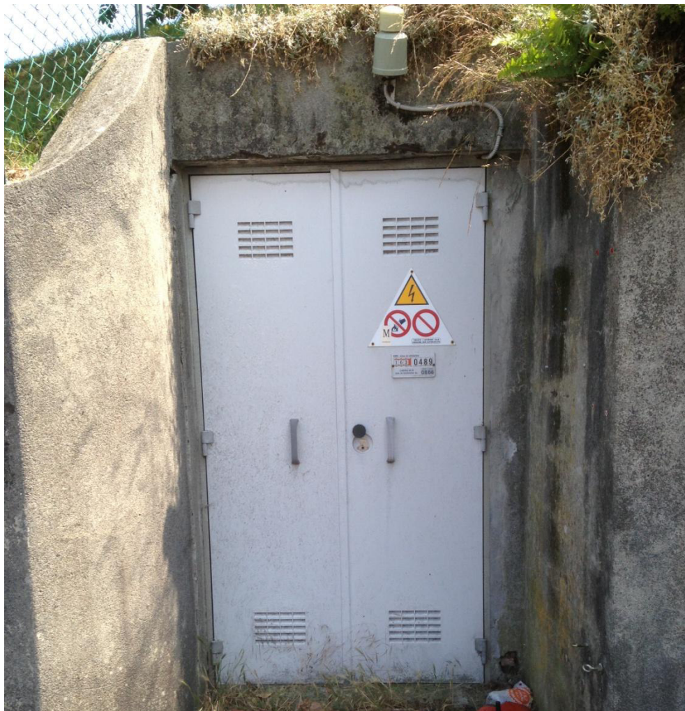
QE0023 Magognino - ubicato entro cabina ENEL ubicata in via delle Machere
